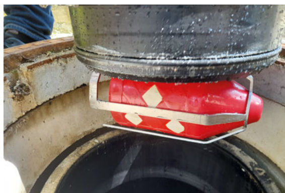
Abb. 2: Molchstation vom Handel, Leitungszwischenpunkt
