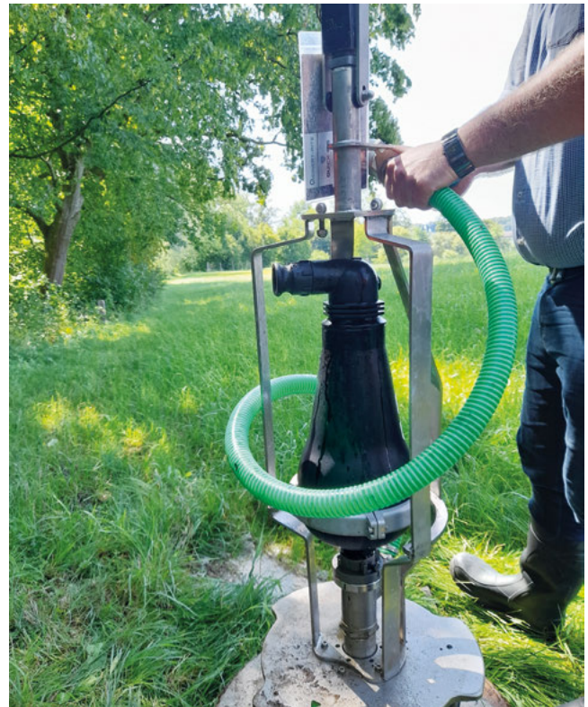
Abb. 4: Ventileinsatz im Spülschacht
