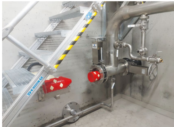
Abb. 1: Molchstation in Eigenbau, Pumpenschacht
