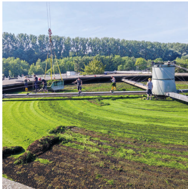
Abb. 2: Wartungsarbeiten können leicht ausgeführt werden (Foto ZKA)
