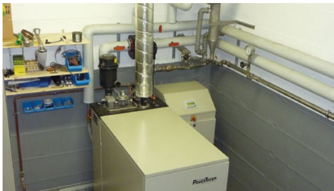
Abb. 3: Faulgas effektiv verwerten mit dem PowerTherm®-BHKW
