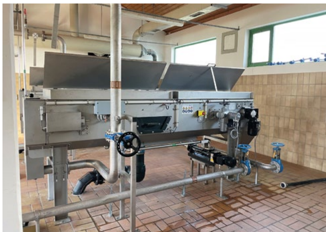
Abb. 4: Bandeindicker zur Überschussschlamm-Entwässerung
