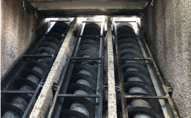
Abb. 2: Noch immer leistungsfähig, die 40 Jahre alten Schneckenpumpen
