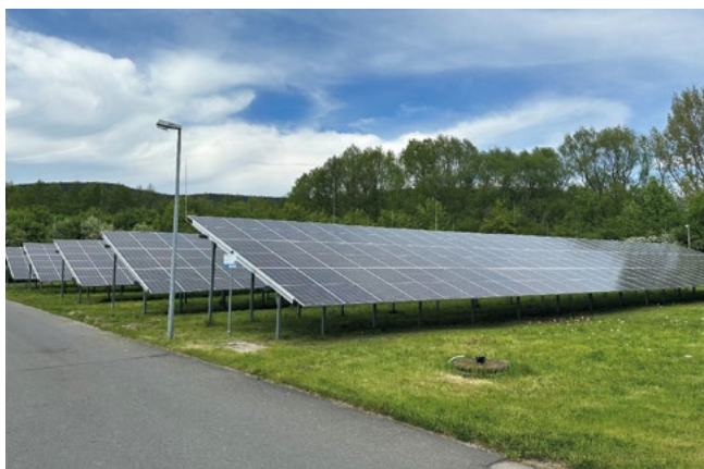
Abb. 3: Photovoltaik-Anlage mit 459 Modulen
