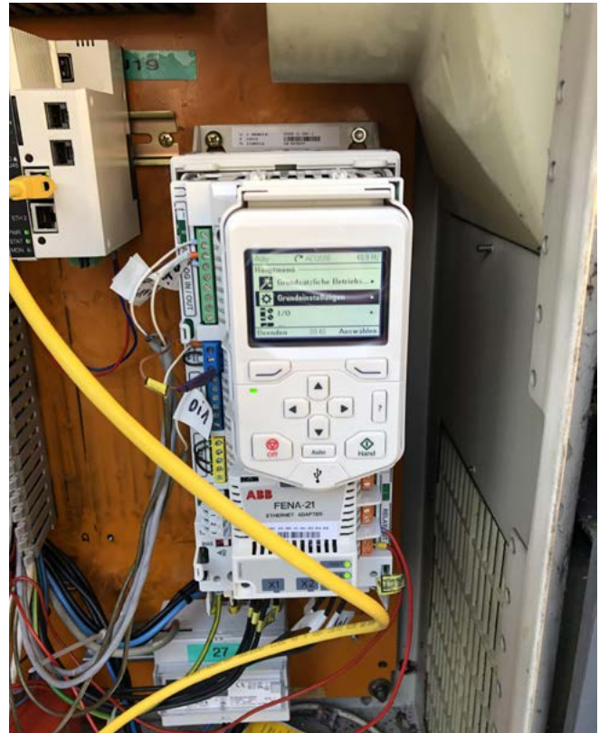
Abb. 3: Seit der Installation des ACQ580-Frequenzumrichters läuft die Pumpe störungsfrei (Foto: ecosmart Energy GmbH).
