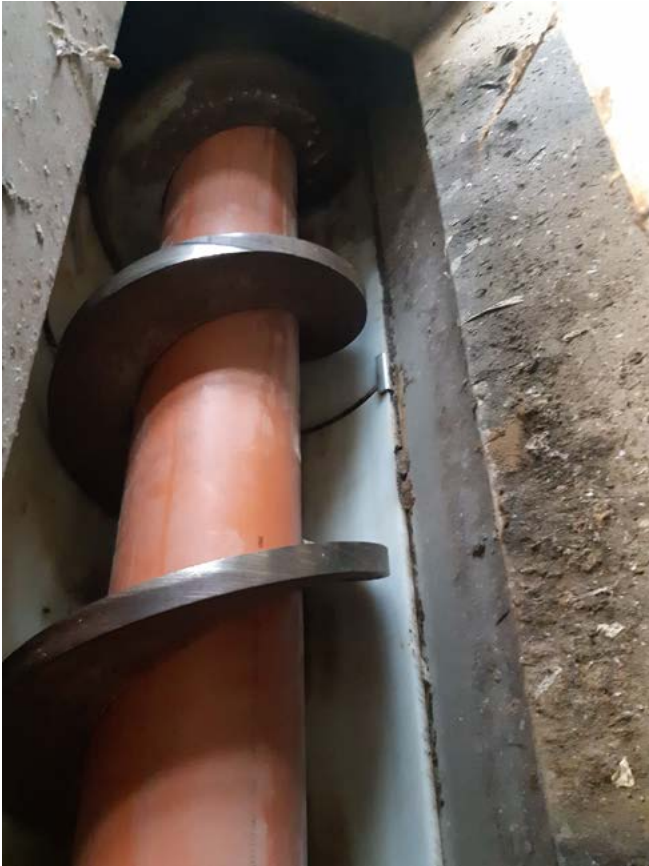
Abb. 4: Jetzt ein störungsfreier Betrieb
