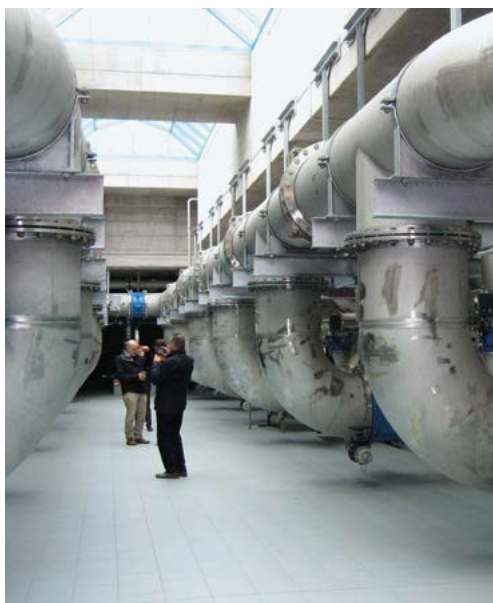
Titelbild: Rohrgang der Flockungsfiltration auf der Kläranlage des Zweckverbands Böblingen-Sindelfingen (Foto: Manfred Fischer, Gauting)
