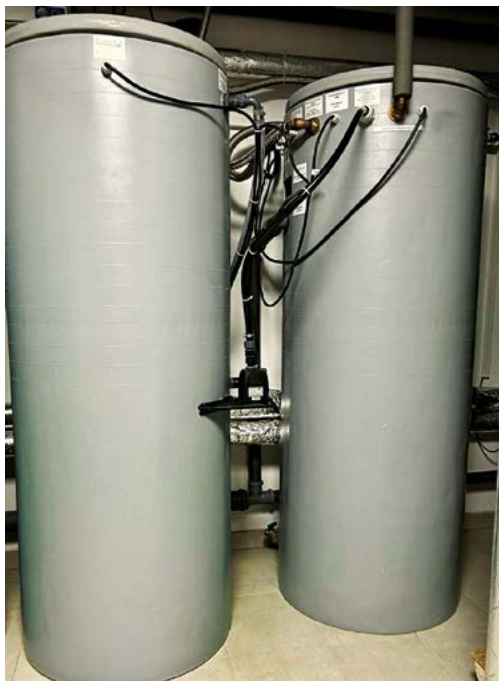
Abb. 1: Die Anlage mit den Tanks wie eine kleine Kläranlage
