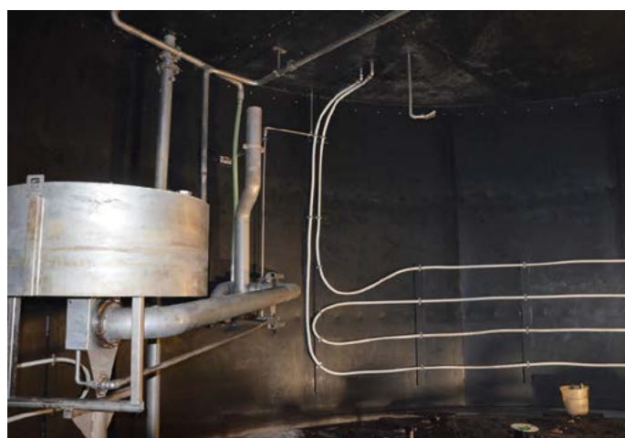
Abb. 2: Betonbecken inkl. Einbauten
