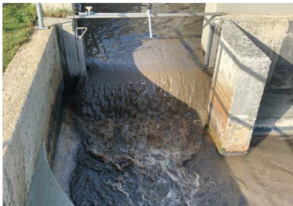
Abb. 2: Sauerstoffeintrag durch den Absturz des Rücklaufschlammes in Kaskade 1
