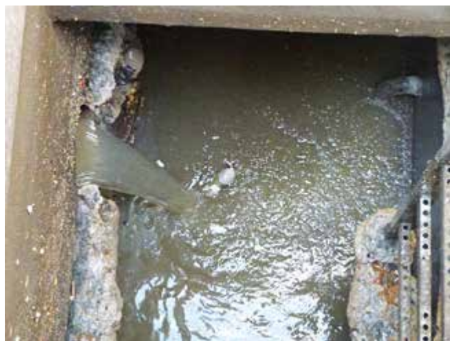
Abb. 1: Einsturz mit Lufteintrag
