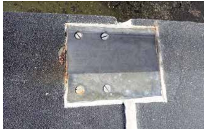
Abb. 2: Laufbahn der Vorklärbecken – fünf Jahre nach der Sanierung
