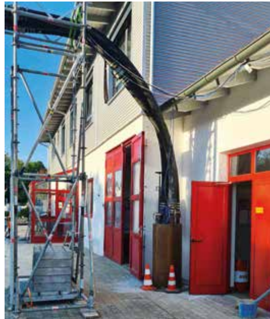
Abb. 5: Der Sammeltrichter für die Rücklaufschlammleitung von den Belebungsbecken über dem Rücklaufschlammtrichter
