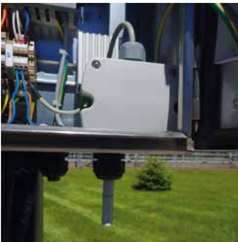
Abb. 8: Feuchtesonde, unten am Schaltschrank
