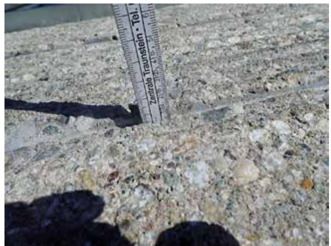
Abb. 6: Nuttiefe Heizleitungen – ca. 10 mm
