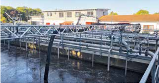
Abb. 4: Die eingehängten Rücklaufschlammumpen in Belebungsbecken 3, dahinter sind die Becken 2 und 1 mit eingehängten Pumpen für den Rücklaufschlammkreislauf zu erkennen.
