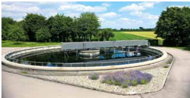
Abb. 1: Schaut doch eigentlich ganz gut aus das Nachklärbecken – doch der Schein trügt
