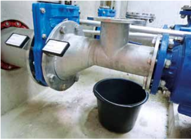
Abb. 3: Saugleitung mit ungünstig gestalteter Putzöffnung
