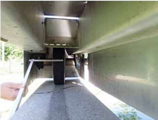
Abb. 1: Rad 70 mm im Mai 2019 – vor der Sanierung
