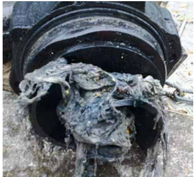
Abb. 5: Offenes Zweikanallaufrad mit Verstopfung im Strömungskanal
