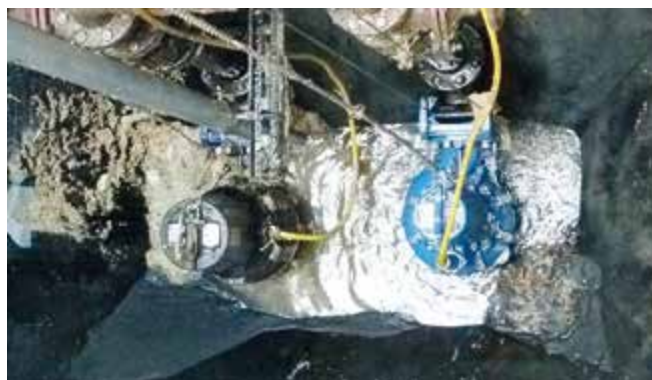
Abb. 2: Pumpensumpf mit Ablagerungen
