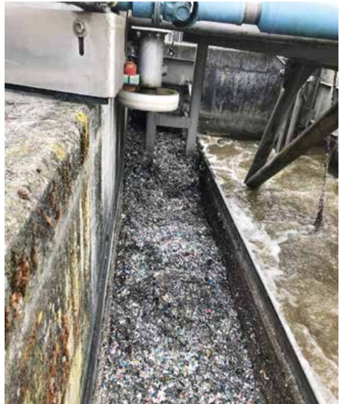
Abb. 4: Auch der Fettfang ist überlastet.
