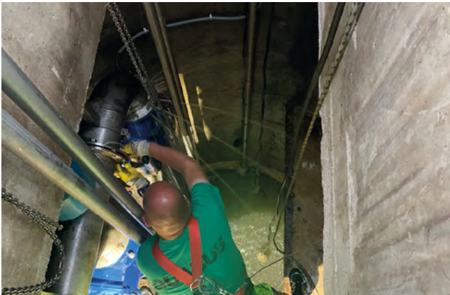
Abb. 6: Entleerung der gefüllten Druckleitung durch Öffnen eines Rohrflansches (leider kein Entleerungshahn eingebaut, wurde im Zuge der Inspektion nachgerüstet)
