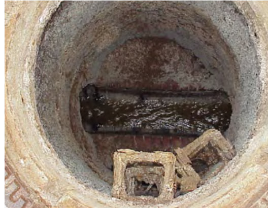
Abb. 3: Auch ein Schacht muss gewartet werden. Bei dieser starken Korrosion von Beton und Steigeisen besteht dringender Sanierungsbedarf.
