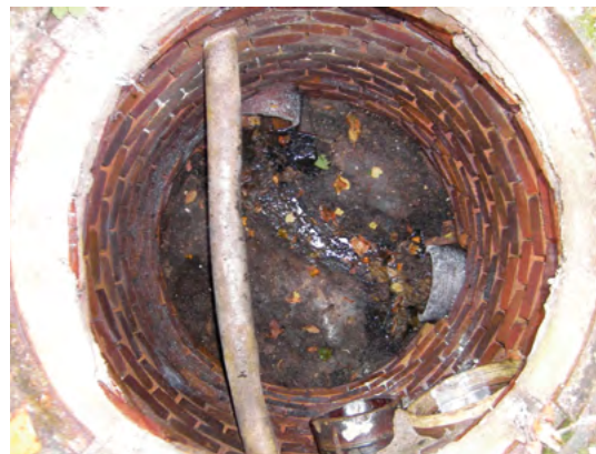
Abb. 4: Ein glatter Durchschuss. Diese Wasserleitung kreuzt den gemauerten Kanalschacht.
