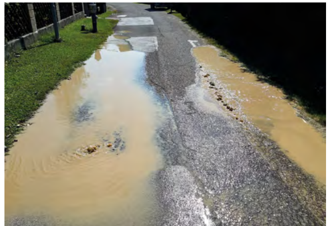
Abb. 8: Abwasseraustritt nach geborstener Druckleitung infolge der Druckprüfung (Versagen des Asbestzement-Materials bei lediglich 40 mbar über Betriebsdruck)
