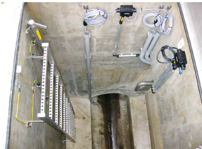
Abb. 6: Bei diesem Einstieg zum Klärüberlaufs stimmt fast alles. Von der Leiter, dem Erdungskabel bis zum Schutz der Kabel. Doch für den Arbeitsschutz fehlt eine Halterung zur Verlängerung der Steigleiter über die Straßenoberkante.
