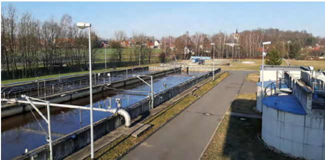
Abb. 1: Lampen über der biologischen Abwasserbehandlung
