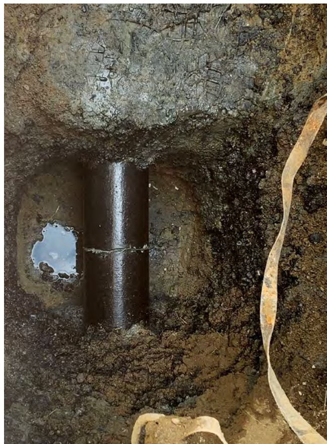
Abb. 2: Radialer Riss der Druckleitung nach örtlicher Aufgrabung.
