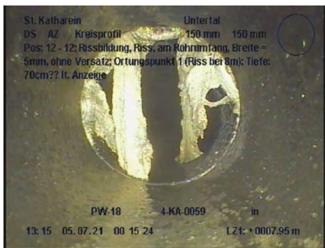
Abb. 1: Radialer Riss einer Druckleitung. Kein augenscheinlicher Abwasseraustritt. Nur durch TV-Inspektion festgestellt.
