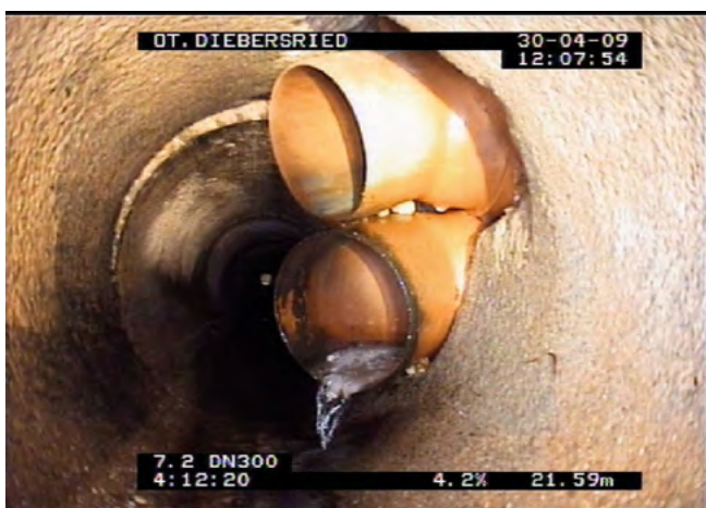
Abb. 8: Schau auf die Röhren. So was gibt es wirklich! Da fehlt es an der Bauüberwachung und Bauabnahme.
