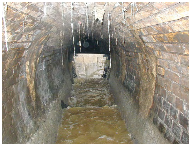
Abb. 11: Zur Wartung dieses Eiprofils ist ein Spülhant im Einsatz. Der Erfolg ist aber überschaubar. Kritik an der Arbeitssicherheit!
