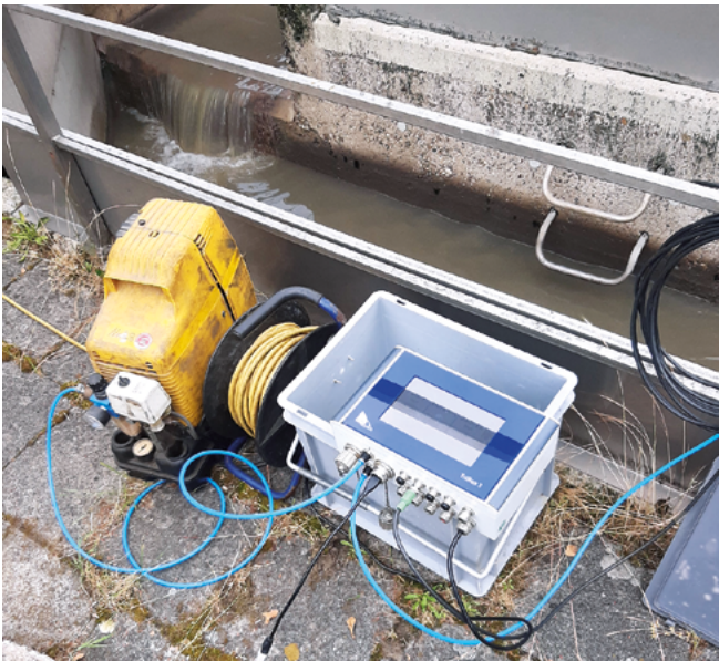
Abb. 2: Die Geräteeinrichtung der Messstelle am Ablauf der Vorklärung, von links: kleiner Kompressor für die Impulsreinigung des Sensorkopfes, Kabeltrommel und die blaue Box als Auswertegerät
