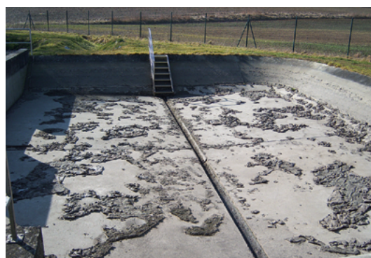
Abb. 6: Dies ist ein Regendurchlaufbecken , das viel häufiger beaufschlagt wird. Doch auch hier sollten die Ablagerungen schnellstens vor dem nächsten Niederschlag entfernt werden, sonst „entfernt“ der nächste Regenguss die Stoffe ins Gewässer. Hier fehlt auch ein Sicherheitsgeländer.
