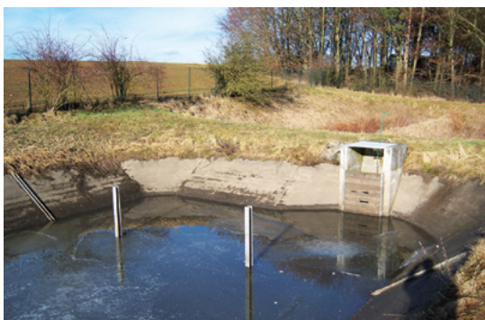
Abb. 2: Es geht noch besser. Warum nicht gleich die ganze Trennwand weg? Bei diesem Regenklärbecken können keine Schwimmstoffe mehr zurückgehalten werden.
