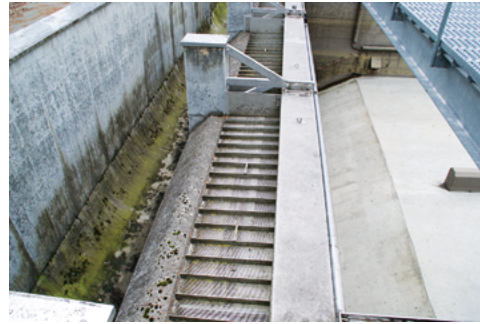
Abb. 11: Bei diesem Regendurchlaufbecken verhindert ein Sieb beim Klärüberlauf die Einleitung von größeren Stoffen ins Gewässer.
