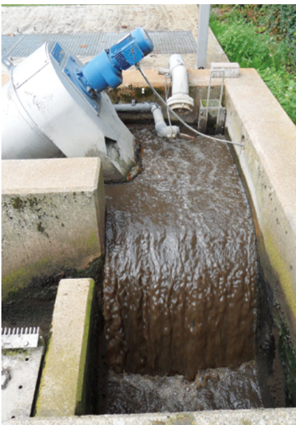
Abb. 7: Perfekte Dosierung Rücklaufschlammschnecke
