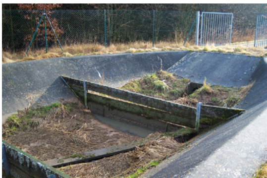
Abb. 3: War der Sommer so trocken, dass sich bei diesem Regenrückhaltebecken so ein Bewuchs bilden konnte oder wurden die Ablagerungen lange Zeit schon nicht mehr entfernt? Man braucht wenig Fantasie, um zu ahnen, was beim nächsten Starkregen passiert.
