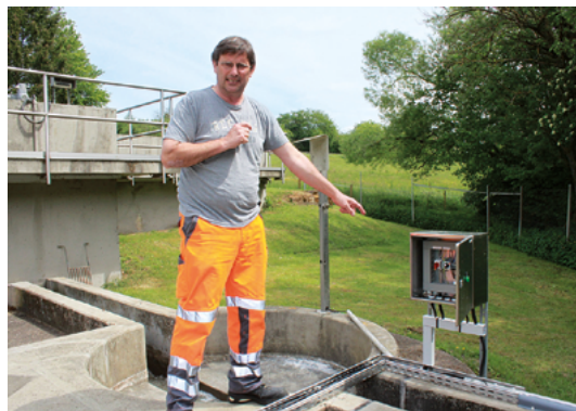
Abb. 2: Am Schacht gestattet es ein Schaltschrank, den Zerkleinerer manuell zu starten und zu stoppen. Die gesamte Steuerung ist in den bestehenden Schaltschrank und damit in die zentrale Leitwarte integriert. Ein Display zeigt die Kennwerte wie die Anzahl der Starts, Reversierungen und die Laufzeiten aus den acht Wochen seit Inbetriebnahme.
