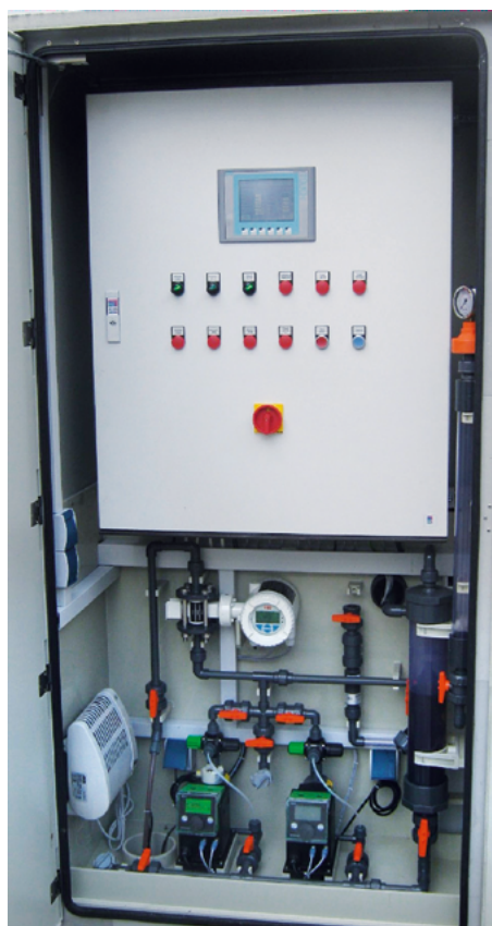
Abb. 11: Dosieranlage für ein Stabilisierungsbecken
