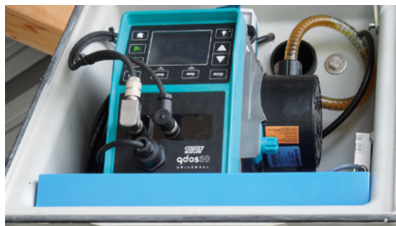
Abb. 9: Schlauchdosierpumpe über Tank
