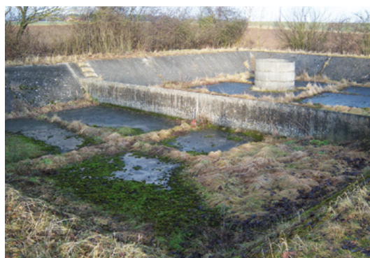
Abb. 5: Endlich ein betoniertes Regenrückhaltebecken , da ist doch die Wartung viel leichter. Aber auch da gilt die alte Weisheit: Der Zahn der Zeit – ohne Wartung holt sich die Natur wieder alles zurück.
