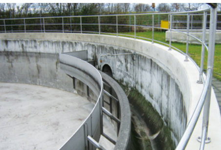
Abb. 10: Der Klärüberlauf eines Regendurchlaufbeckens mit Tauchwand und auch mit Geländer, was unbedingt zur Sicherheitseinrichtung gehört.
