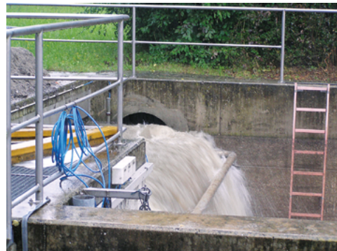
Abb. 13: Regenwetterzulauf in ein Regendurchlaufbecken mit vorbildlicher Ausstattung.
