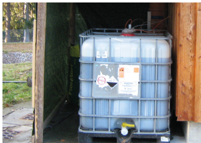
Abb. 1: IBC im Zulauf einer 400-EW-Anlage
