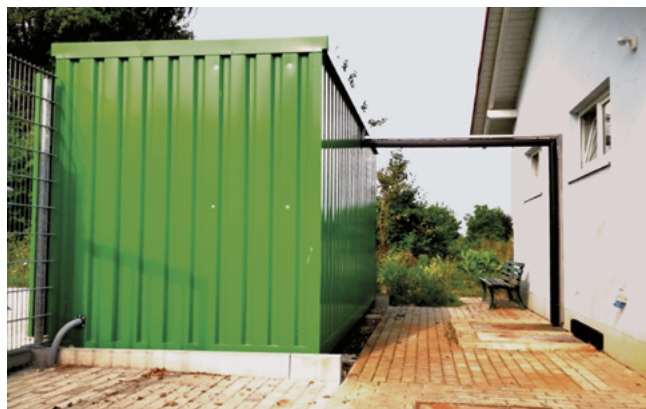
Abb. 5: Dosiercontainer mit Zuleitung zur Impfstelle
