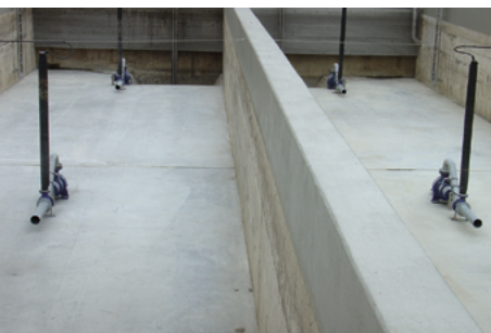
Abb. 8: Dieses Regendurchlaufbecken besitzt als Spüleinrichtung Strahlreiniger, die nach Abklingen der Überlaufphase einsetzen, damit die absetzbaren Stoffe in Bewegung bleiben und zum Kläranlagenzulauf gebracht werden.
