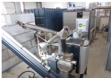
Abb. 2: Die neue Trocknungsanlage
