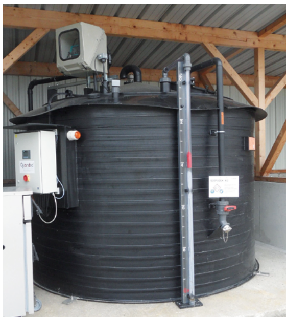
Abb. 8: Tankanlage mit Schaltschrank
