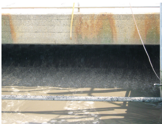
Abb. 4: Schlechte Dosierstelle in Belebung
