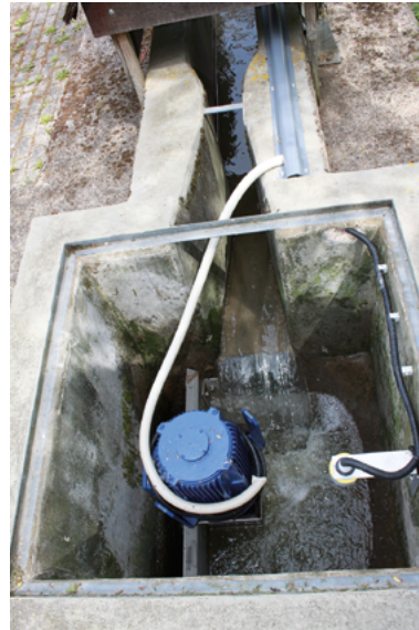
Abb. 4: Eine Ultraschall-Füllstandsmessung (rechts an der Schachtwand) schaltet den Zerkleinerer abhängig vom Wasserstand ein und aus.
