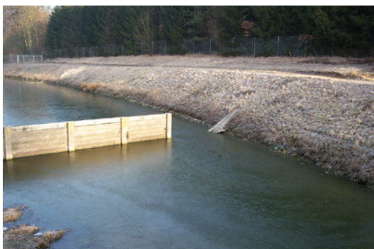
Abb. 1: Die Trennwand sollte bei diesem Regenklärbecken dafür sorgen, dass Schmutzstoffe aus dem Regenwasser zurückgehalten werden und nicht ungehindert ins Gewässer gelangen.
