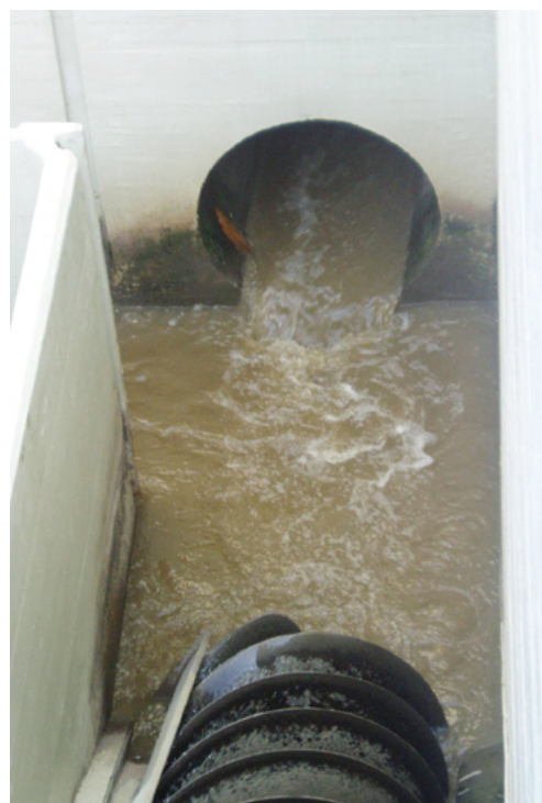
Abb. 6: Der Fremdwasseranfall konnte deutlich gesenkt werden.
