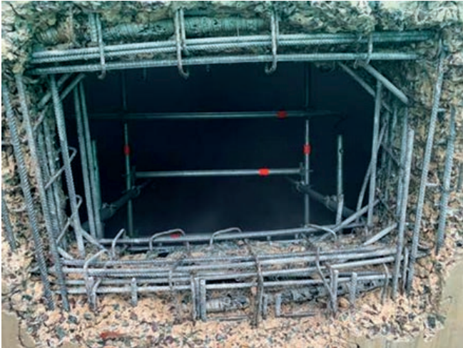
Abb. 11: Das Mannloch ist freigestrahlt.
