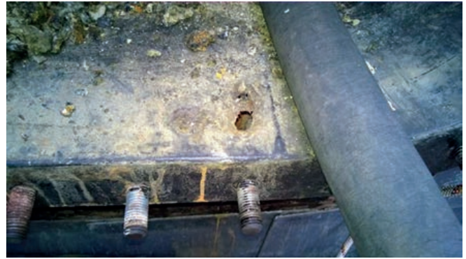
Abb. 9: Die defekte Stelle am Mannloch
