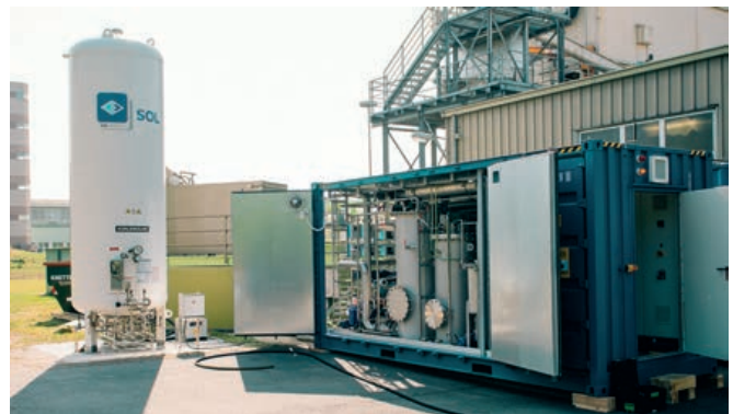
Mobile Pilotanlage zur Phosphor-Rückgewinnung
