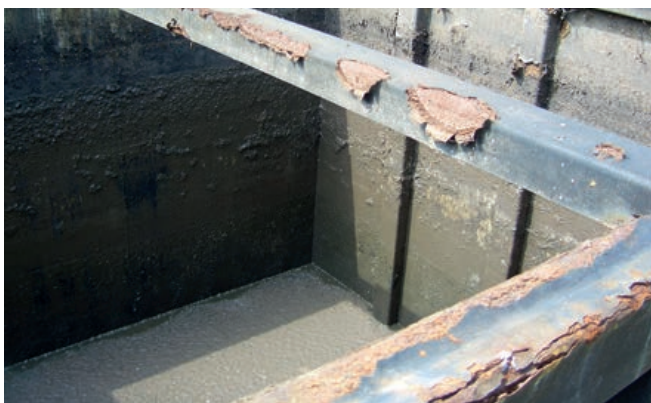
Abb. 1: Der Stahlbehälter ist in die Jahre gekommen
