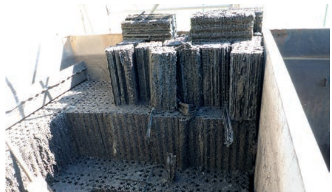
Abb. 2: Ausbau der alten Festbetten in den ersten beiden Becken (von insgesamt vier)
