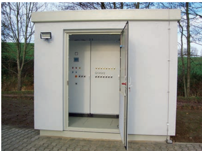
Abb. 6: Neue Elektrotechnik in einer „gasfreien“ Betonraumzelle
