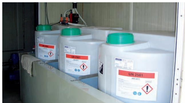
Abb. 7: Neue Dosierstation zur Phosphorelimination
