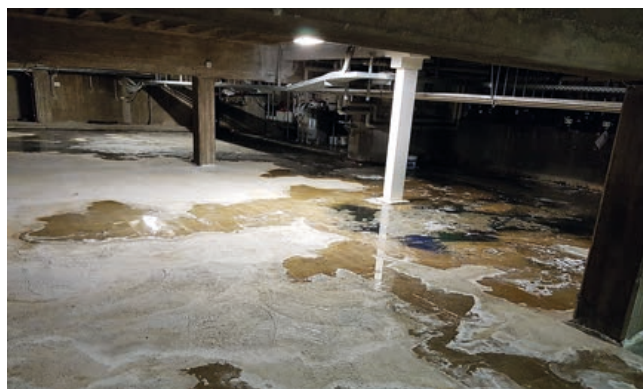
Abb. 2: Ein Fettsee im Untergrund des Hauptbahnhofs einer deutschen Großstadt, verursacht durch einen geplatzten Fettabscheider
