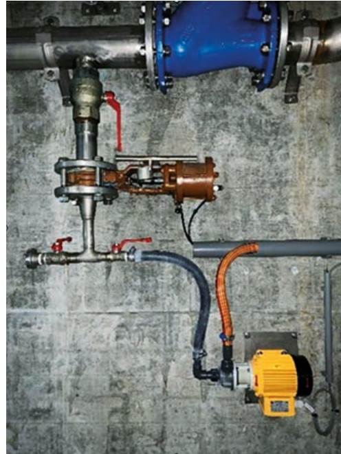
Abb. 5: Der Teilstrom wird mit einer kleinen Pumpe (gelb) entnommen.
