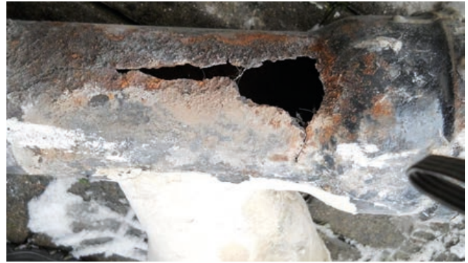
Abb. 4: Korrosionsschäden an Gussrohrleitungen von Hausinstallationen
