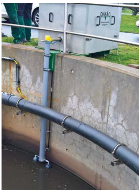
Abb. 2: Aufstellung der Dosierstation am Ausgleichsbecken; Fallrohr mit Schwimmvorrichtung
