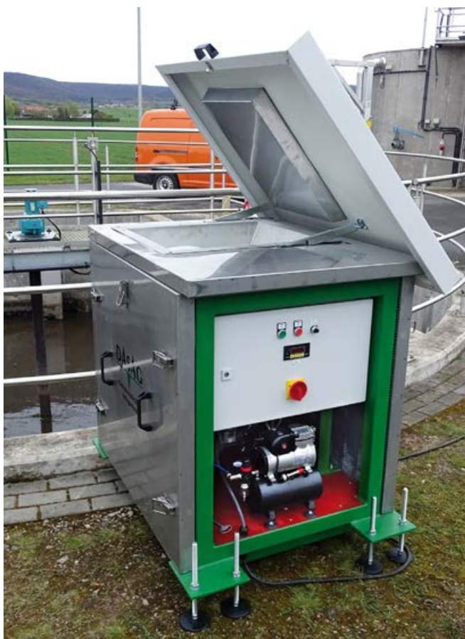
Abb. 1: Dosiersystem mit Einschütte und Steuereinheit
