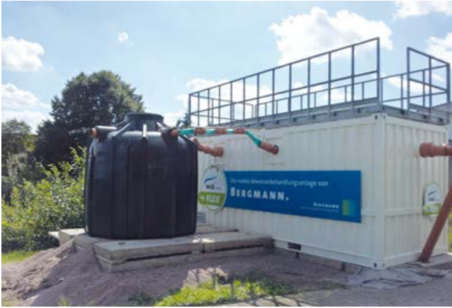
Abb. 1: Containerkläranlage als Interimslösung für 200 EW
